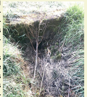
La capacité d'évacuation de cette buse sera réduite d'au moins 50%
